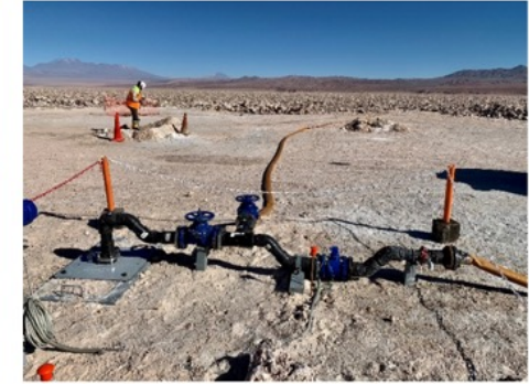
Pozo de reinyección CL-194 (R2)
